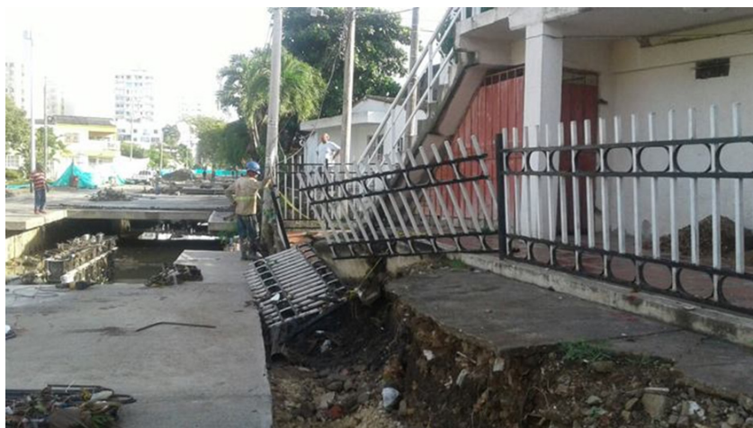
Imagen 10. Caño Emiliano Alcalá en el Barrio El Socorro Recuperada el 27 de abril del 2019 en https://www.eluniversal.com.co/cartagena/colapsa-casa-en-el-socorro-tras-intensas-lluvias-duena-culpa-al-distrito-262999-DUEU375655
